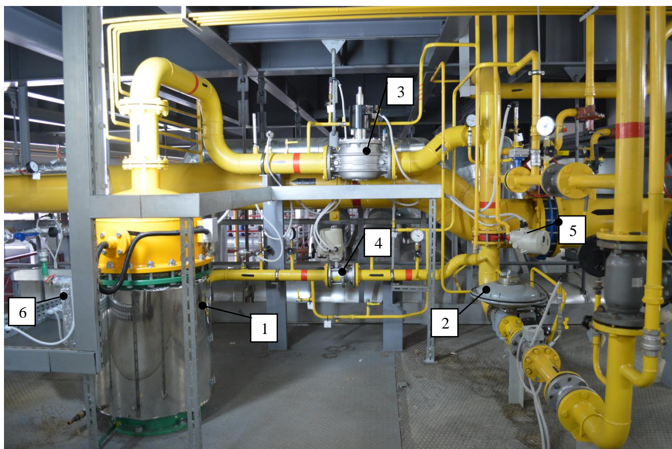
Состав основного оборудования: 1 – турбогенератор ТГ-15-6-Н; 2 – регулятор давления; 3 – предохранительно-запорный клапан; 4, 5 – запорные клапана; 6 – контур подогрева газа.
